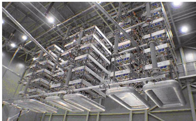
Figura 2.2-2: Válvulas de tiristor antisísmicas e ignífugas en transmisión de larga distancia en Guizho-Guangdong, China
