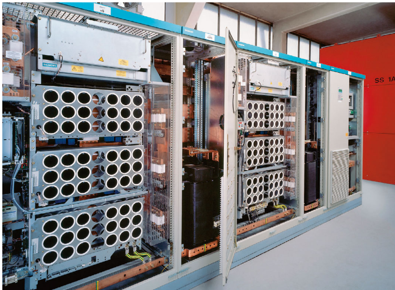
Figura 2.3-1: SIPLINK con puertas de armario abiertas
