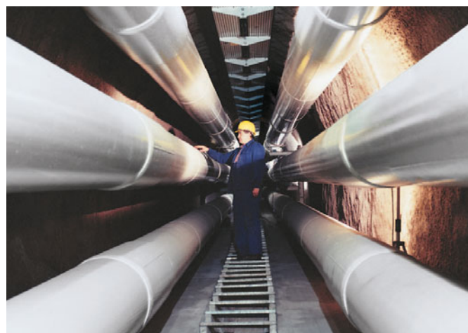
Figura 2.5-1: Disposición de GIL en el túnel del bombeo central eléctrica en Wehr, sur de Alemania (4000 m de longitud; en servicio desde 1975)
