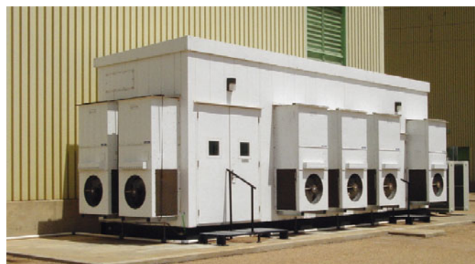
Figura 2.9-6: SIEHOUSE en Lubbock (Texas) para alimentar ventiladores de tiro forzado en la planta generadora
