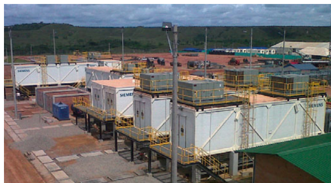
Figura 2.9-4: 19 E-houses SIEHOUSE para suministro de energía a oleoductos en Colombia (ECOPETROL)
