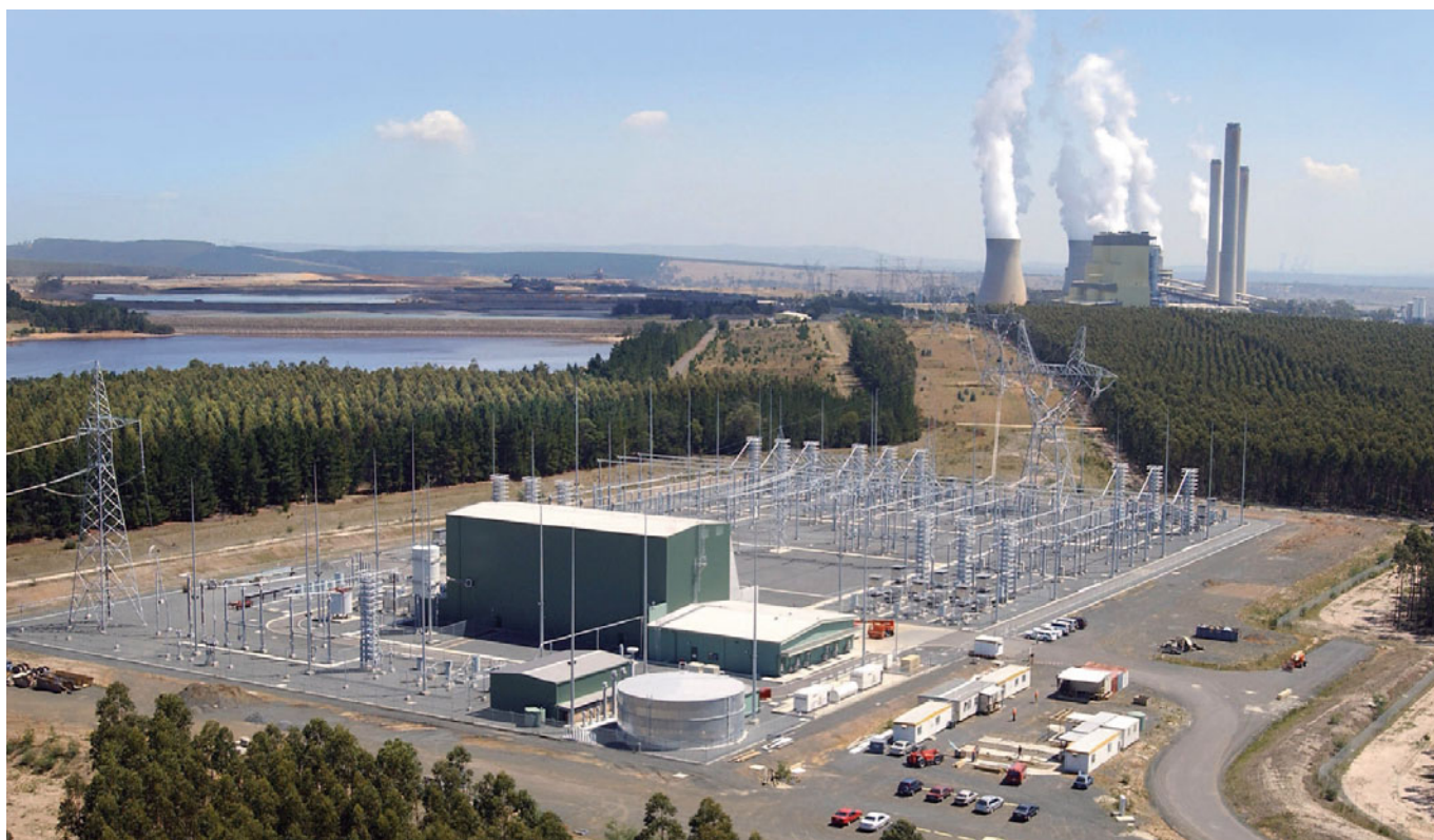
Figura 2.5-25b, c: Proyecto HVDC Basslink de 400 kV en Australia (línea de transmisión monopolar)
