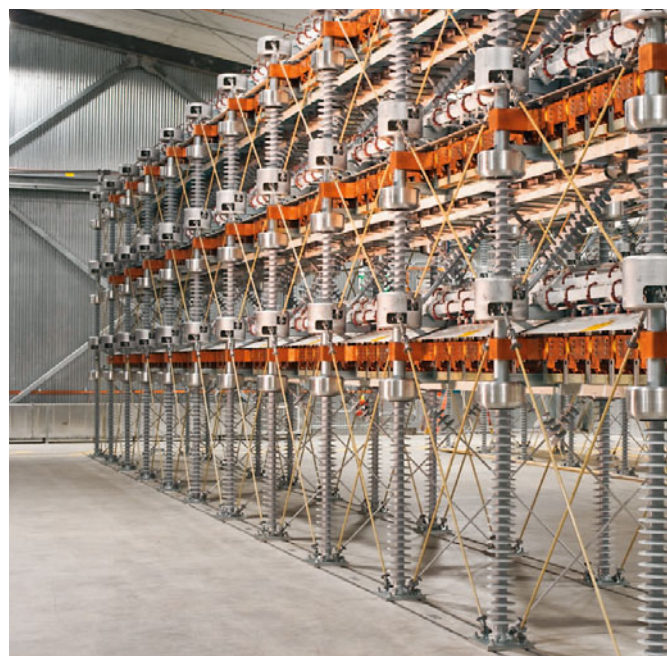
Figura 2.2-7: El corazón de HVDC PLUS es un convertidor multinivel modular (MMC) que se puede escalar de acuerdo con los requisitos de voltaje o potencia. Cable Transbay, EE. UU.
